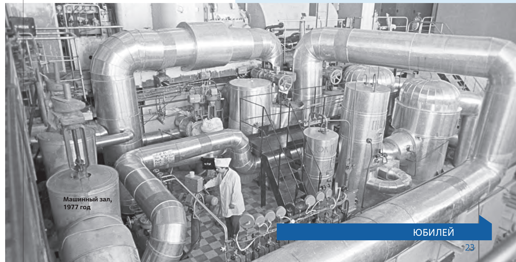
Трубы, по которым передается тепло от Билибинской АЭС, 1977 год
